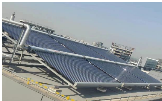
图例：公司总部顶楼配置的光伏太阳能热水器
